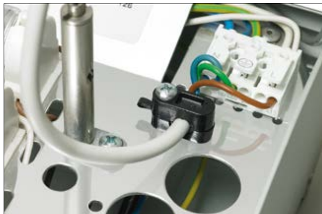
KK-sarjan vedonpoistaja asennettuna.
