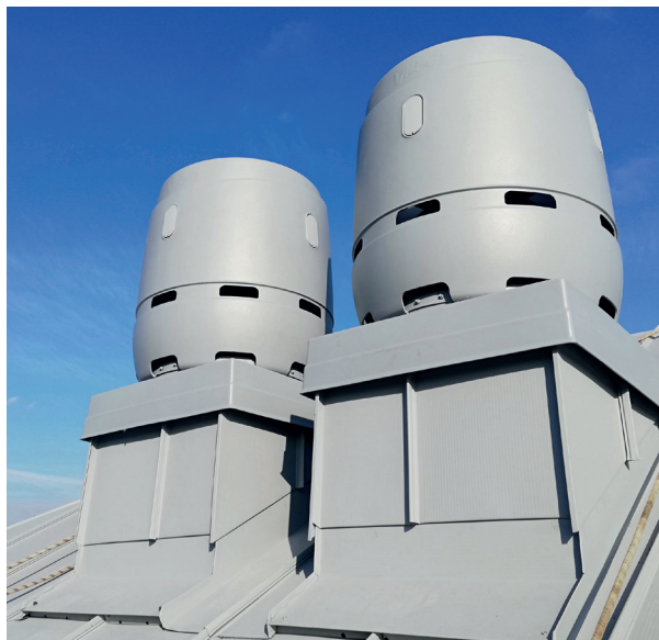
Hopeanharmaat VILPE 315/400S FLOW -poistot asennettuina kaltevalla katolla. Kuvan läpiviennit ovat asiakkaan rakentamat.
